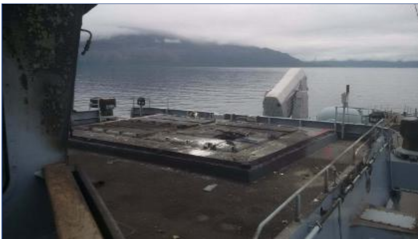
Das Vertical Launch System der „Sachsen“ nach der Fehlfunktion. (Quelle: 2018 Bundeswehr) Größere Abbildung anzeigen
